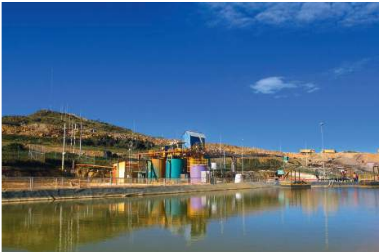
Planta de tratamiento de agua. Unidad La Zanja.
